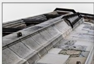
Schäden nach früherer Hydrophobierung Foto: AeDis
