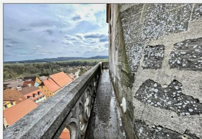
Unsachgemäße Ausbesserung von Werksteinen mit Putz sind mit ein Grund für die Schäden
